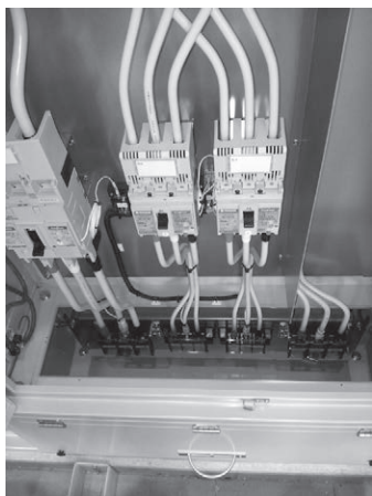
イベント会場の持込機器分電盤 下部がターミナルになっている
